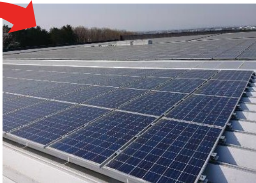
▼屋上に太陽光発電システムを設置
